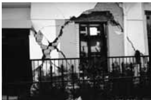
Фиг. 1 Пукнатини между прозоречните отвори и същевременно разрушаване на двуслойните тухлени стени
