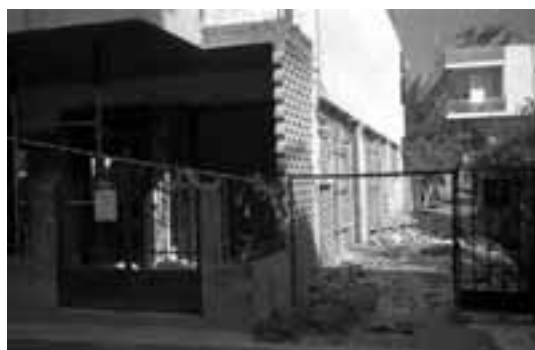
Фиг. 2 Напълно отделяне на външния слой на двуслойна тухлена стена в Ано Лиосиа
